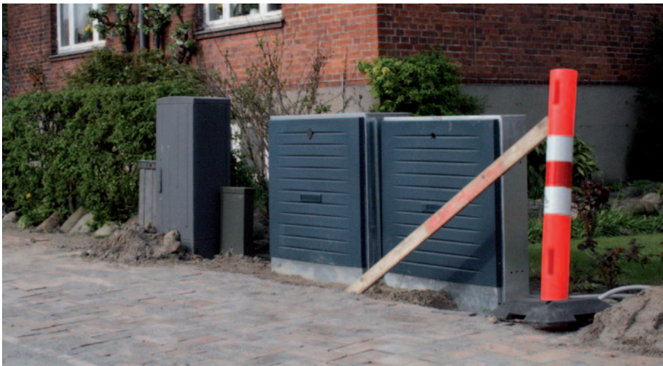
To af de nye elskabe på Mogensensvej. Foto: Kuréren
